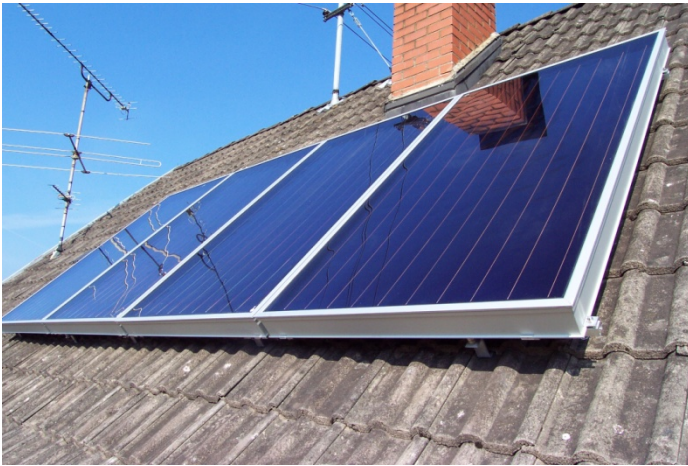
Figure 3.1 : Module solaire du toit
